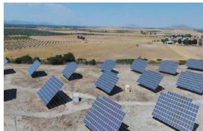
Vista panorámica de nuestra planta fotovoltaica.
